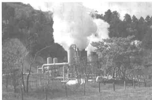
工場のような景観の地熱発電所（鬼首地熱発電所）
